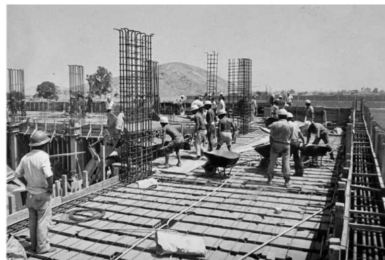
Construcción de las estructuras en base a pórticos de columnas y vigas Fuente: Archivo institucional de la AOP (2023)
