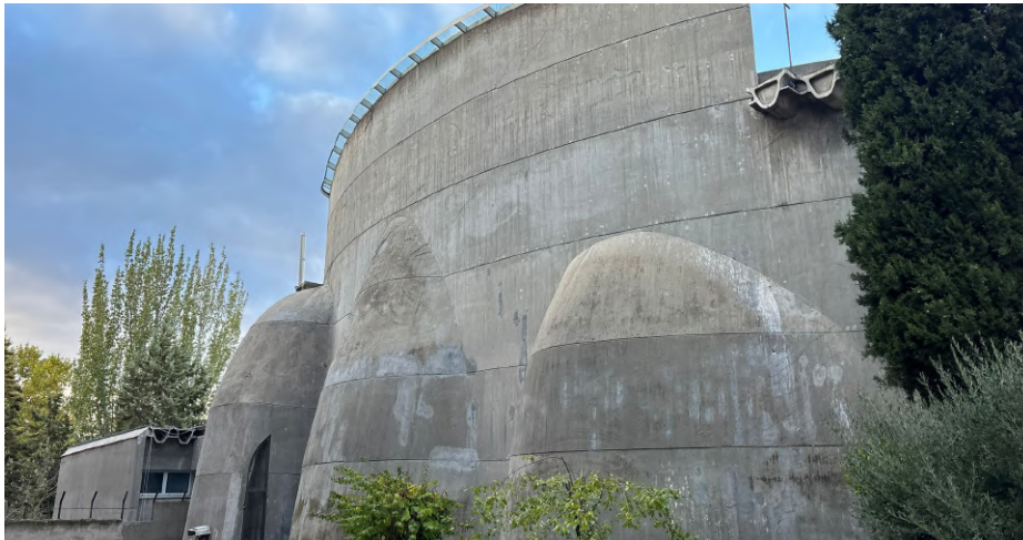
Figura 68. Vista exterior de las concavidades de hormigón
