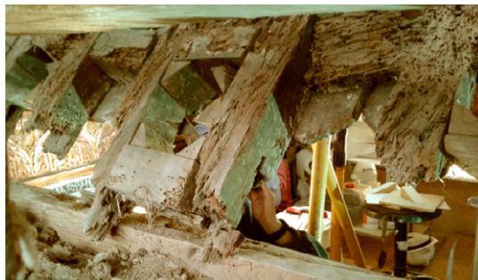
Figura 87: Estado inicial de la zona inferior de la cubierta.
