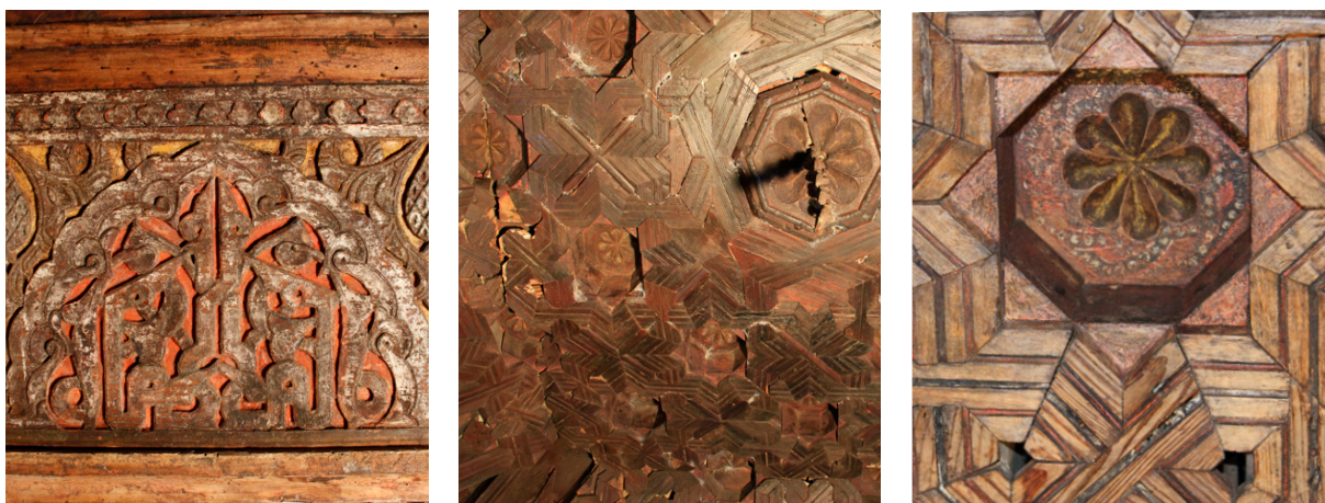
Figura 71: Estado previo a la intervención de las policromías en cubierta. Fuente: Ártico (s.f.).
