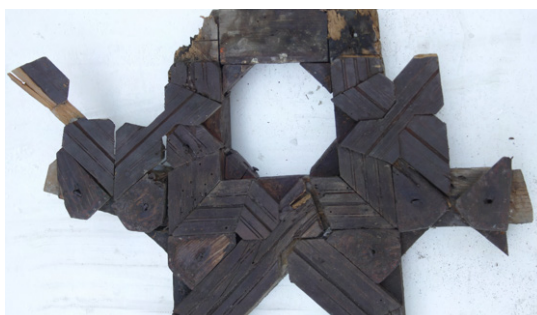
Figura 80: Par deteriorado de la cubierta interna del oratorio.
