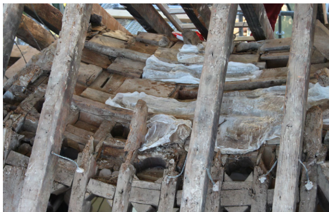
Figura 69: Estado previo a la intervención del almizate. Fuente: Ártycó (s.f.).
