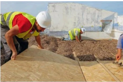
Fig 47. Fuente: Revista digital arquitectura viva. Fotografías de proceso de esparcido y encajonado de posidonia en cubierta.
