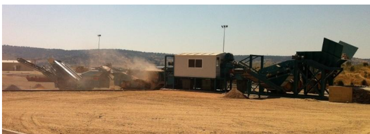
Fig 3.30. Maquinaria de planta modular de tratamiento
