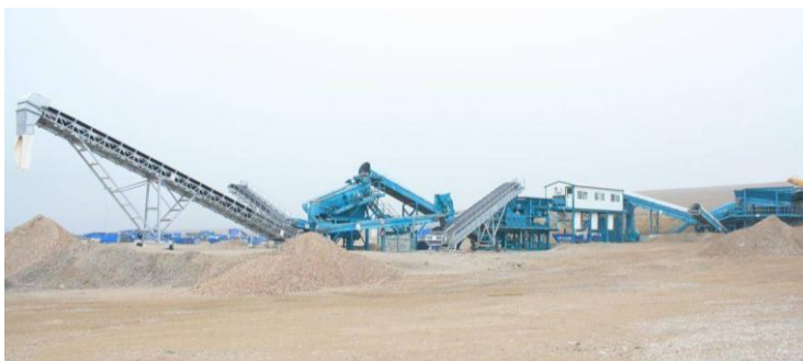
Fig 3.29. Maquinaria de planta fija de tratamiento
