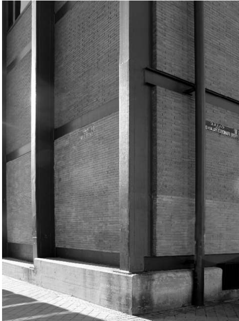
FIG. 18. Diario Arriba. Detalle de la esquina, 2020. Fotografía del autor.
