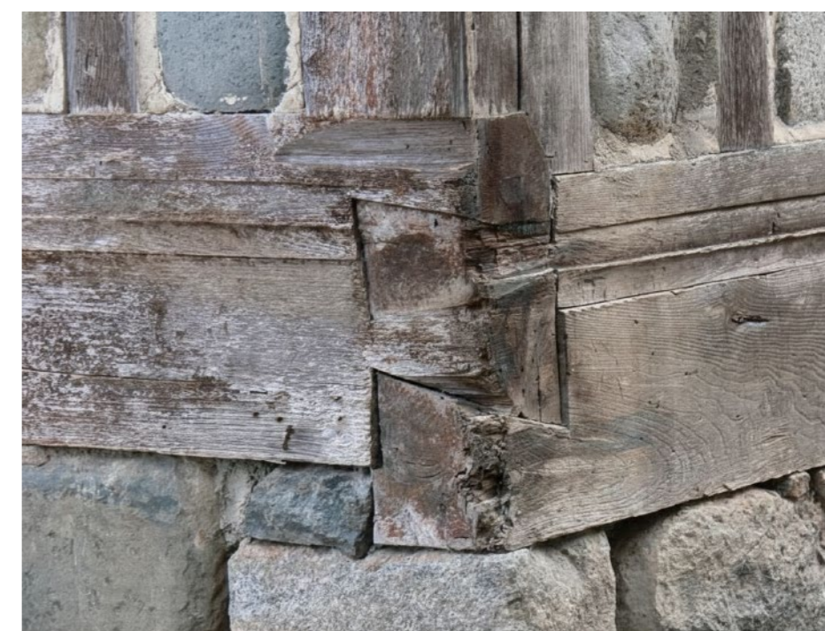
Fig 6.17. Detalle del encuentro del entramado de madera de la Casa Aydınoglu Fuente: (Güler, 2012)
