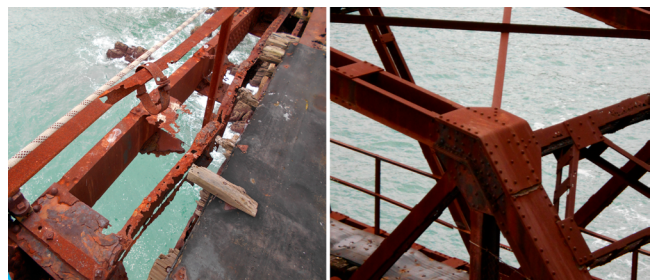
Figura 10. Vistas del cordón inferior casi desintegrado (izq.) y del cordón superior de la celosía en buen estado (dcha.)
