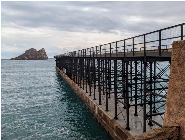
Figura 3. Vista del embarcadero de El Hornillo desde la costa durante las obras de restauración
