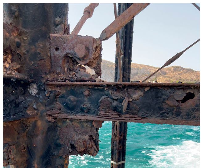
Figura 11. Unión entre pilar y arriostamientos en el embarcadero de El Hornillo, en el que se acumula el agua y se produce una corrosión de la placa de unión, por lo que el tirante sería incapaz de transmitir cargas si fuera necesario su colaboración
