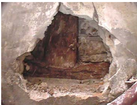
Fig. 1.3/1. Cala en el revestimiento de yeso de un muro con entramado de madera. El pie derecho aplasta a la carrera. No es un problema de inestabilidad pero genera grietas en paredes y revestimientos, y hace que la carrera superior se apoye en el cuajado de fábrica y no en el pie derecho
