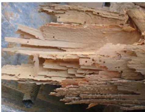
Fig. 3.2.A/3. Madera atacada por termes. La desaparición de la madera de primavera deja a la pieza con un aspecto hojaldrado muy característico. Obsérvense los pequeños agujeros que comunican transversalmente unas galerías con otras
