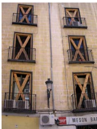
Fig. 5.1.A/1. Apeo de fachada rigidizando los huecos con cruces de S. Andrés y marcos, con tablonés
