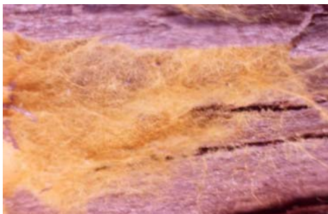
Fig. 2.1.A/5. Hifas y micelio de un hongo sobre la superficie de una viga de madera
