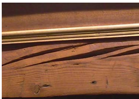
Fig. 2.1.A/1. Fendas en zig-zag de un par de cubierta. Su profundidad y trazado reduce la sección mecánica resistente de la pieza
