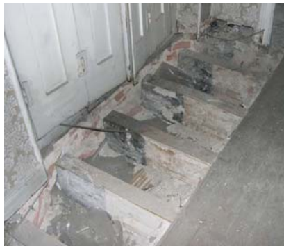
Fig. 6.2/1. Protección original con breá, en las cabezas de las viguetas de un forjado en un edificio de finales del S. XIX
