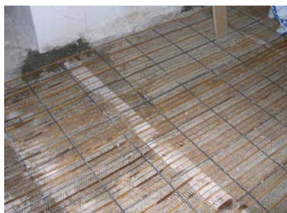
Fig. 5.5.C/3. Losa de hormigón armada desconectada del forjado. Más que como refuerzo funciona como capa de reparto de limitado alcance
