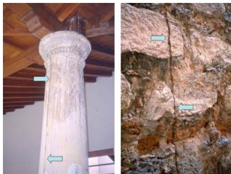
Fig. 2.1.A/4. Galerías de termes para el paso por zonas descubiertas, en un porche y en un muro de sótano
