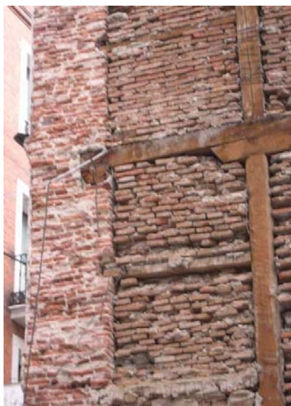
Fig. 3.4.A/3. El enjarje o trabazón entre muros de fachada y medianero únicamente se confía al apoyo de la carrera del muro medianero en la de la fachada
